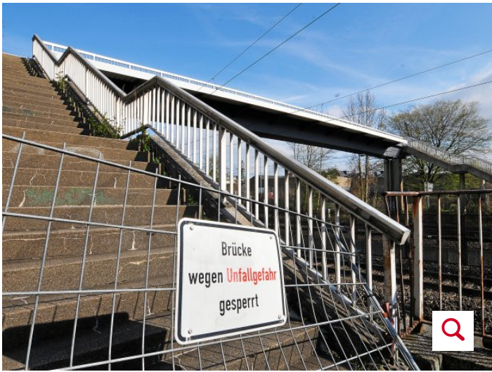
Der Ibach-Steg über die Bahnlinie ist schon seit Jahren wegen Baufälligkeit gesperrt. Foto: Bernd Richter
