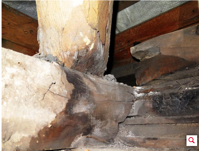
Pilze und Ungeziefer haben die Eichenbalken des Denkmals marode werden lassen. Foto: Bernd Richter / WP
