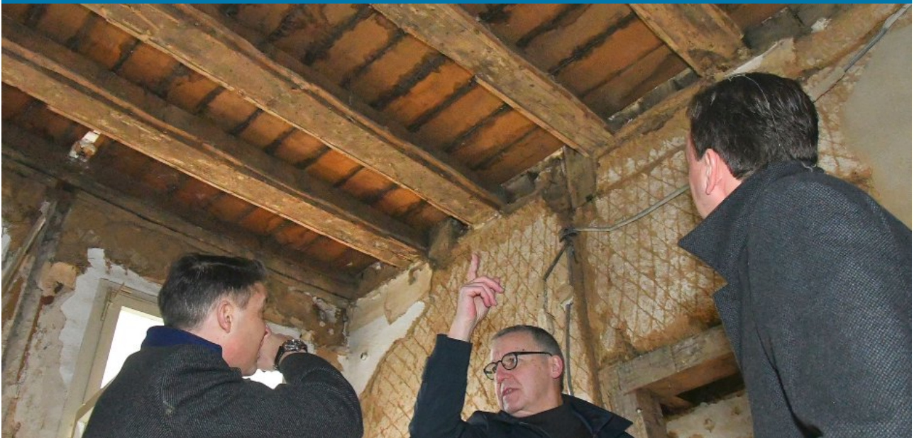
Zurzeit ruht die Baustelle am Bürgerplatz: Architekt Klaus Lange (Bild Mitte) und die Sparkassenvorstände Johannes Schulz (links) und Michael Lindermann machen sich ein Bild vom Baufortschritt Foto: Bernd Richte
